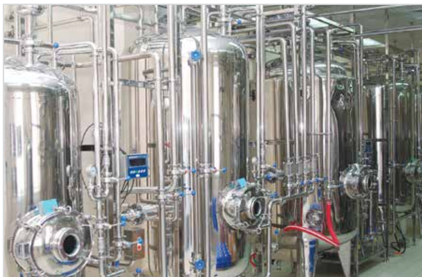
Комплекс по приготовлению растворов и сиропов
