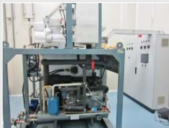
Установка Lyo-5 (SIP, CIP). Система циркуляции теплоносителя
