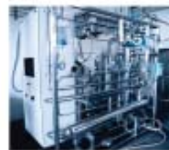
Станции CIP / SIP
