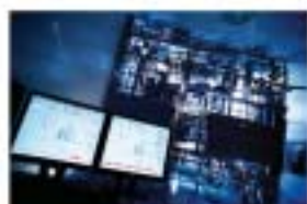
Системы автоматизации производственных процессов
