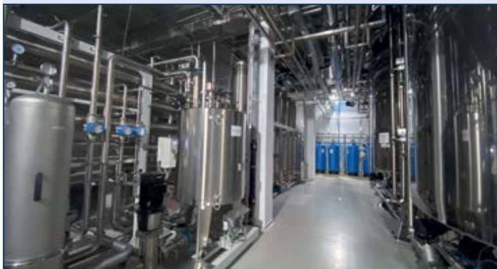
Новый производственный комплекс оснащен системой двухступенчатого обратного осмоса STILMAS BRO 424/PHRO 360 и дистиллятором STILMAS MS 4007 HPS для получения воды для инъекций (ВДИ)
