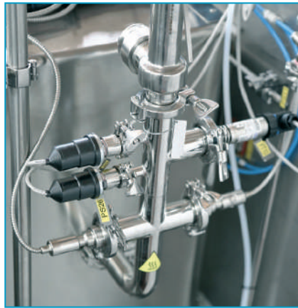
Трубопроводи для автоклава RSA виготовлені з нержавіючої сталі марки 316L із внутрішньою поліровкою до досягнення шорсткості <math><0,35\text{ мкм}</math>.
